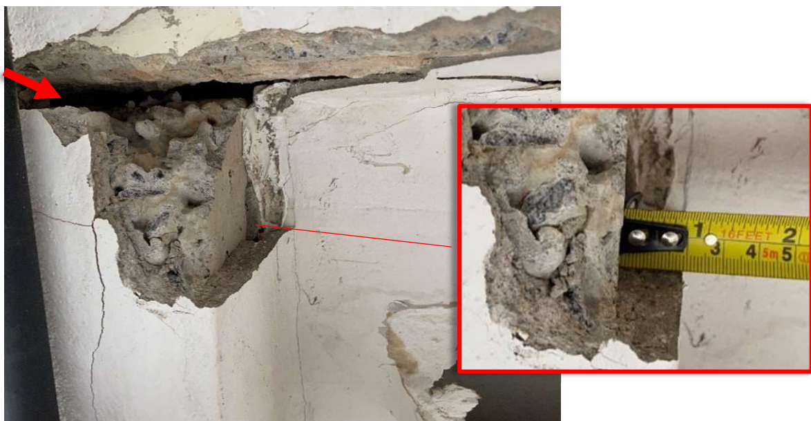
Foto 32 – Foi realizada a remoção parcial do emassamento e constatou-se que este apresenta espessura de 1,90 cm na face interna da viga. Não foi identificado material de preenchimento entre as estruturas no local.
