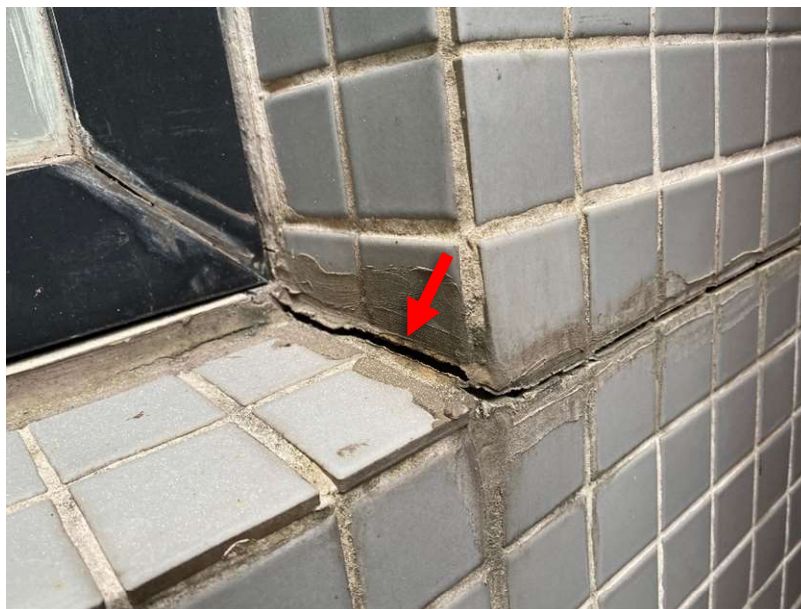
Foto 17 – Foi constatada rachadura de 3,00 mm na alvenaria da passarela, na altura do segundo pavimento.
