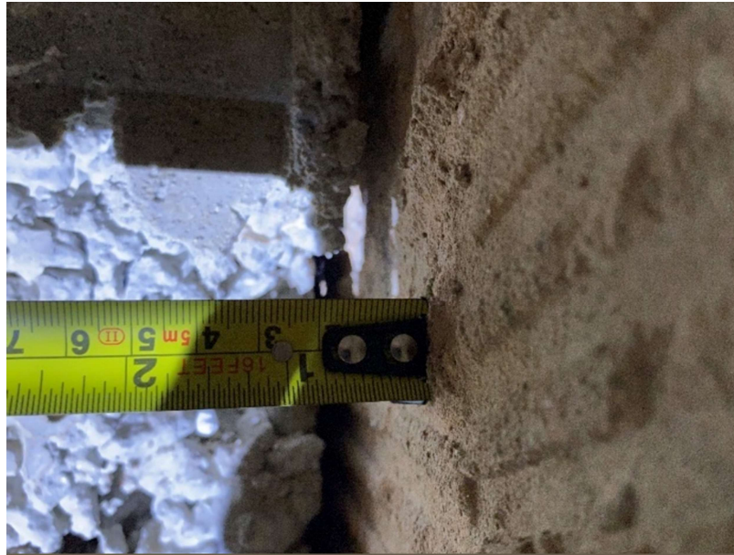
Foto 29 – Foi constatado o afastamento de 2,00 cm entre a viga da passarela e a viga do bloco principal sem material de preenchimento.
