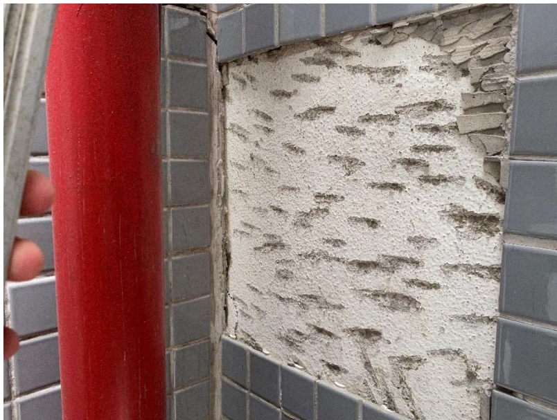
Foto 15 – Foi constatado o destacamento de peça do revestimento cerâmico da fachada do bloco principal, próximo do encontro com a alvenaria da passarela, na altura do segundo pavimento.
