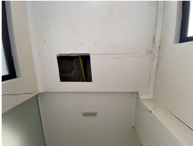
Foto 55 – Vista da abertura no forro de gesso acartonado da passarela de acesso ao Bloco II.
