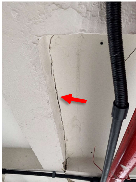
Foto 19 – Foi constatada trinca no forro de gesso no encontro entre a passarela e a fachada do bloco principal.
