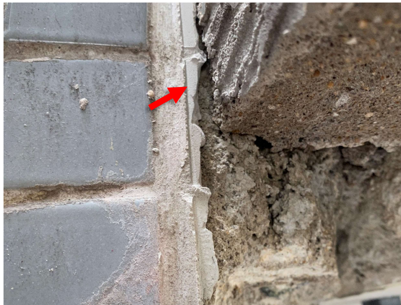
Foto 40 – Vista externa do encontro entre as vigas do bloco principal e da passarela próximo a abertura nº 2, apresentando o uso de rejuntamento rígido no encontro das estruturas em análise.
