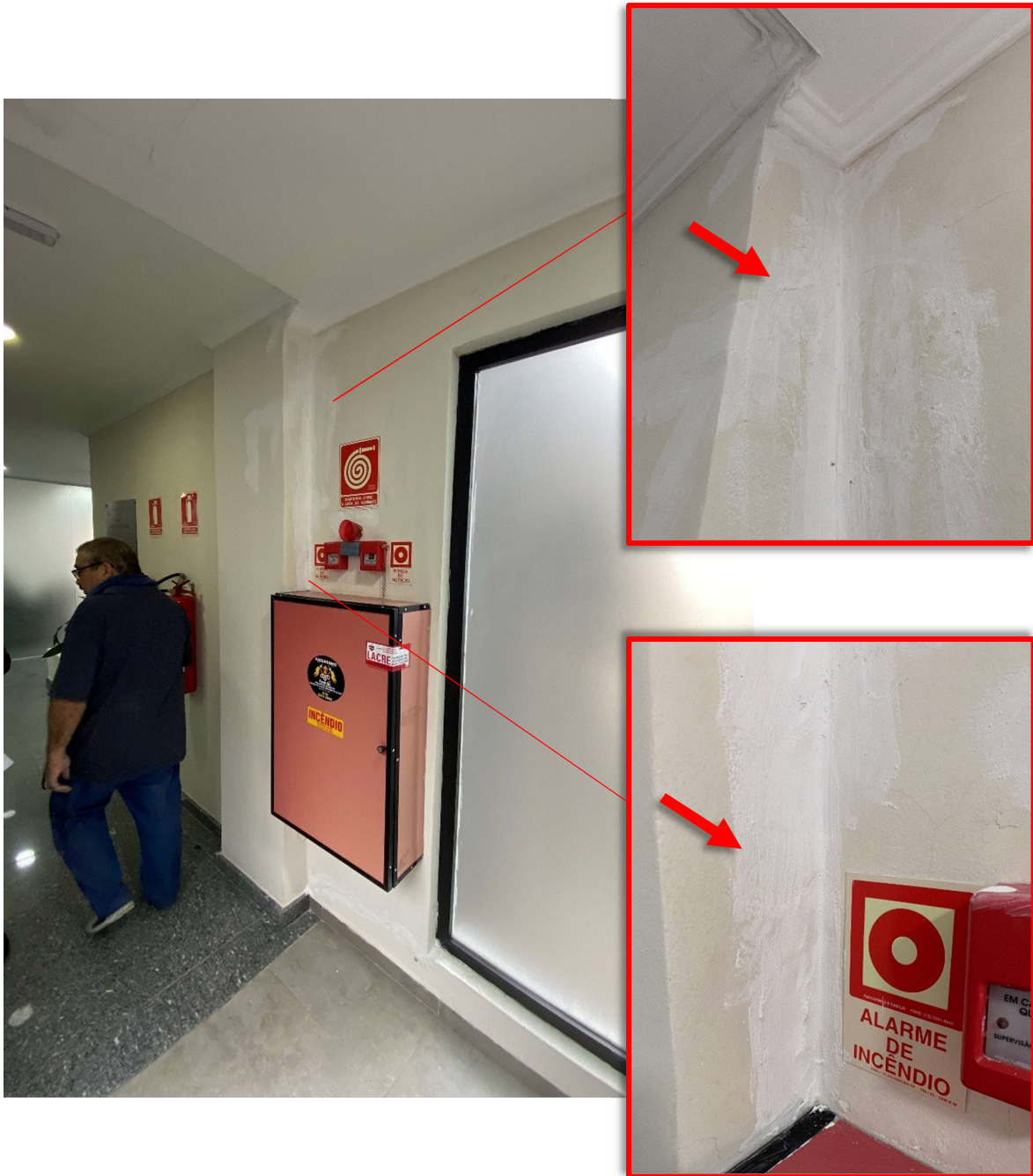
Foto 47 – Foram constatados reparos no encontro das alvenarias do bloco principal e da passarela de acesso ao bloco II. Segundo o zelador, o tratamento das trincas foi realizado em gesso em torno de 3 semanas antes da inspeção realizada. Na vistoria foi apurado que os reparos não apresentavam fissuras.
