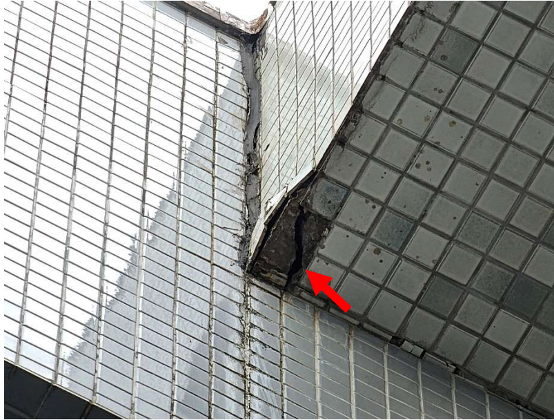
Foto 10 – Foi constatado dano no beiral da fachada do bloco principal, próximo do encontro com a alvenaria da passarela.
