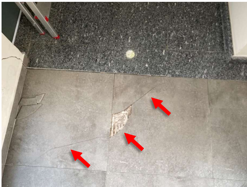
Foto 54 – Foram constatados destacamento de peças e trincas no piso cerâmico próximo ao encontro entre as estruturas do bloco principal e da passarela de acesso ao bloco II.
