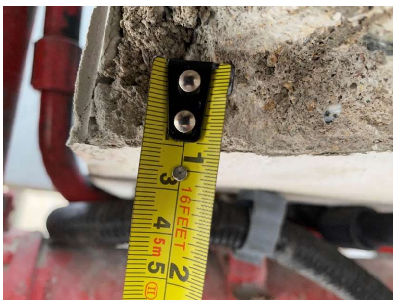
Foto 34 – Foi constatado o emassamento com espessura de 2,00 cm na face inferior da viga.
