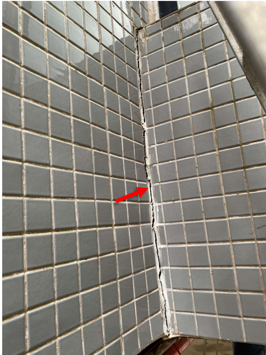
Foto 6 – Foi constatada rachadura entre as alvenarias da fachada do bloco principal e da passarela, na altura do segundo pavimento.
