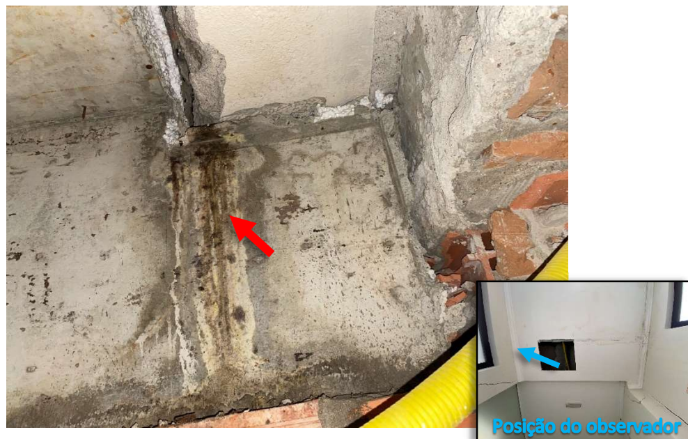
Foto 58 – Foi constatada mancha de infiltração no encontro entre as lajes.
