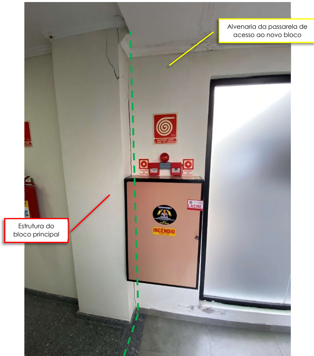
Foto 49 – Foi constatada rachadura no encontro das alvenarias do bloco principal e da passarela de acesso ao bloco II.
