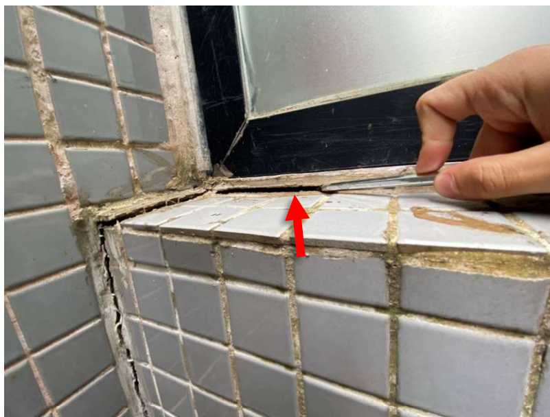
Foto 7 – Foi constatada rachadura entre a esquadria e a alvenaria da passarela, na altura do segundo pavimento.
