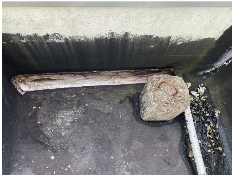
Foto 64 – Foi constatado o reparo em manta aluminizada entre a laje da passarela e beiral do bloco principal, de forma a atenuar as infiltrações na rachadura entre as estruturas.
