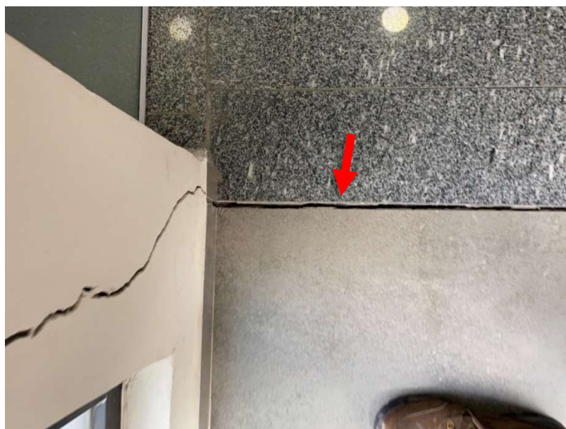
Foto 52 – Foi constatada rachadura no encontro entre os pisos do bloco principal e da passarela de acesso ao bloco II.
