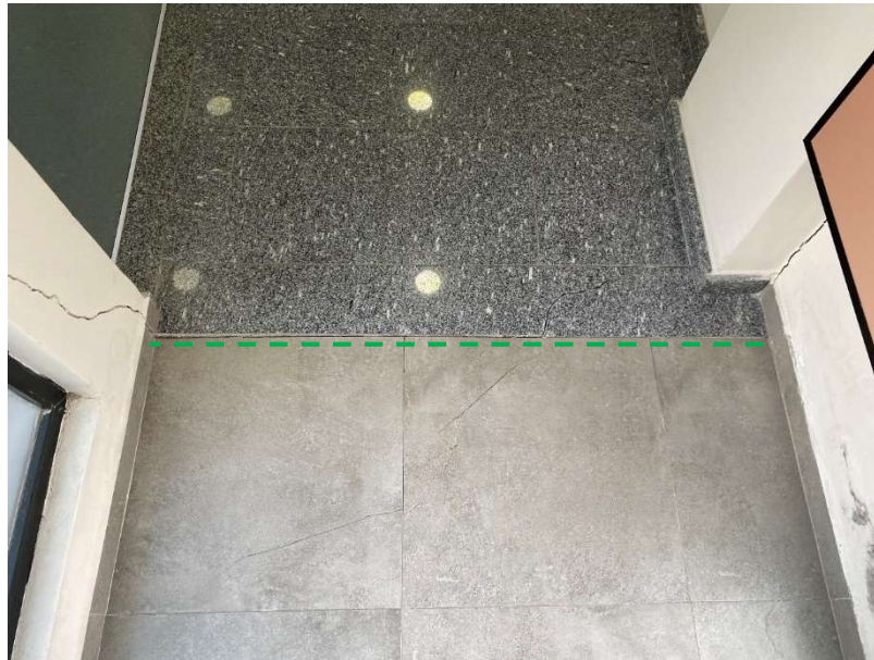
Foto 51 – Vista do local de encontro entre as estruturas que não apresenta junta de movimentação.
