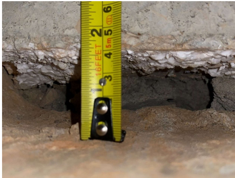
Foto 25 – Foi constatado o afastamento de 4,00 cm entre a laje da passarela e a viga do bloco principal sem material de preenchimento.
