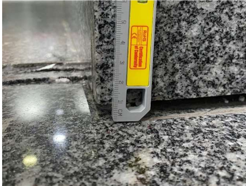
Foto 45 – Foi constatado o recalque de 0,80 cm do piso da passarela de acesso ao Bloco II, correspondendo ao valor apurado do recalque da estrutura apresentado na imagem 33 do presente laudo pericial.
