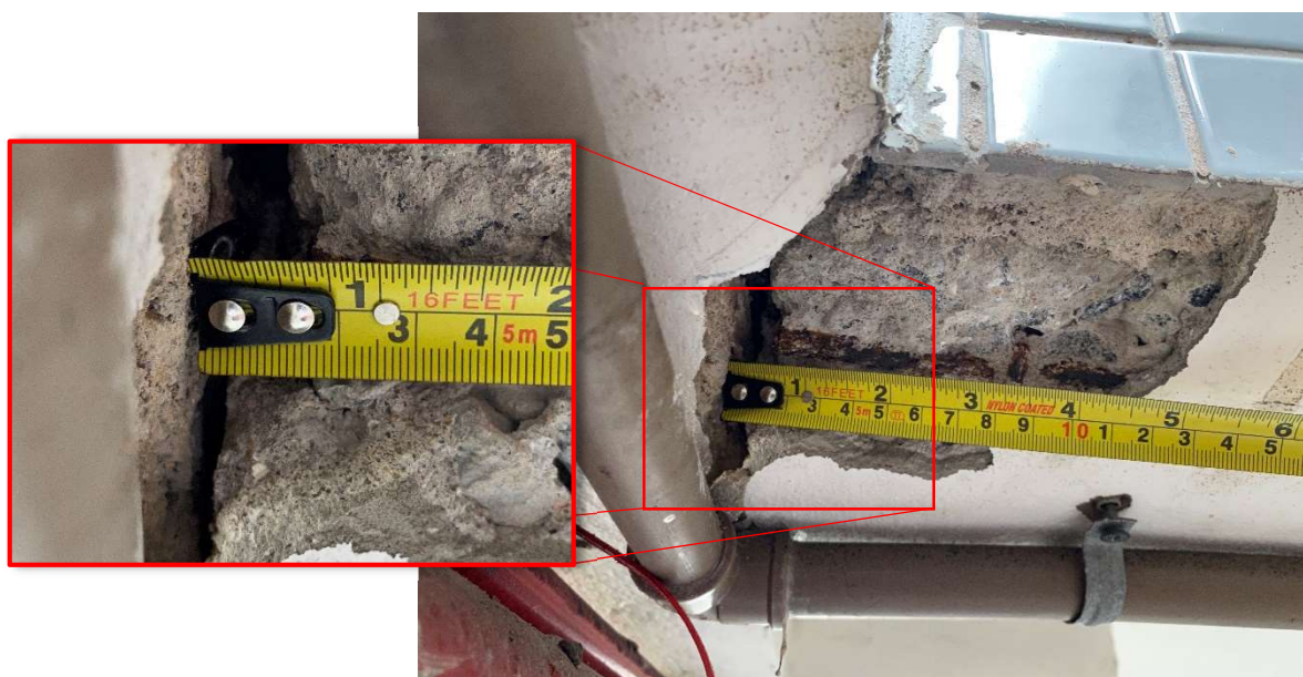
Foto 38 – Foi constatado o afastamento de 1,50 cm da armadura da viga da passarela e a viga do bloco principal.
