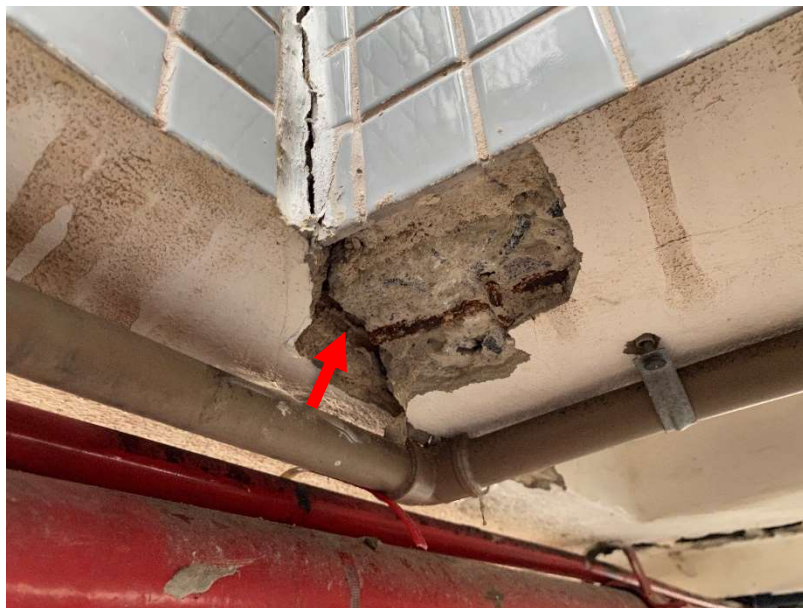
Foto 37 – Constatou-se que o encontro entre as estruturas, próximo aos revestimentos da fachada, não apresentam material de preenchimento.
