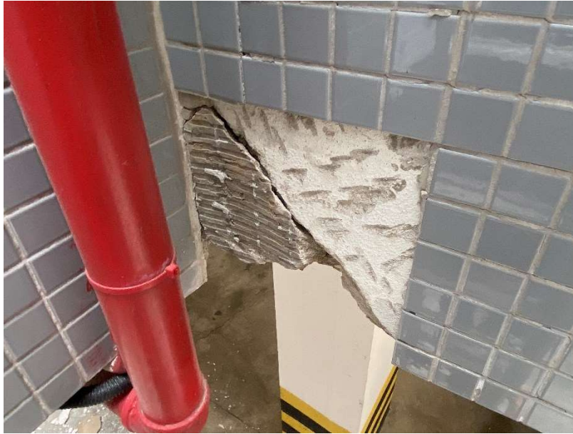
Foto 14 – Foi constatado o destacamento de peça do revestimento cerâmico da fachada do bloco principal, próximo do encontro com a alvenaria da passarela, na altura do segundo pavimento.
