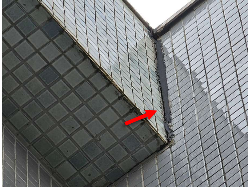
Foto 2 – Foi constatada trinca entre o beiral da edificação principal e a alvenaria da passarela.
