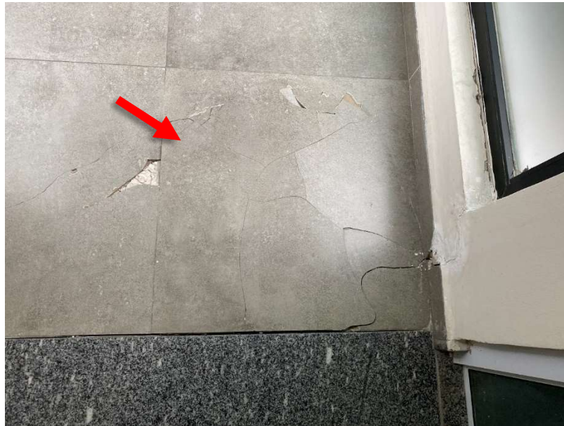
Foto 43 – Foram constatados danos e som cavo ao percutir os pisos cerâmicos da passarela de acesso ao bloco II.
