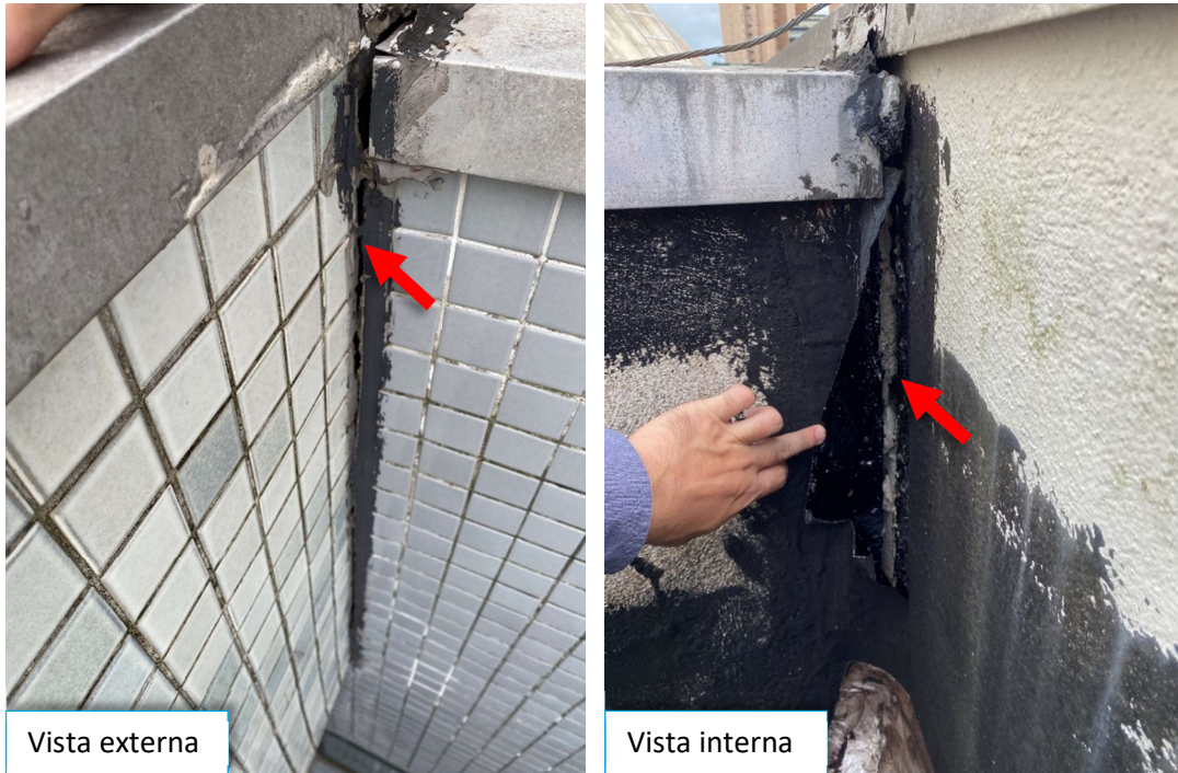
Foto 63 – Foi constatado o afastamento entre as alvenarias do bloco principal e da passarela de acesso ao bloco II.
