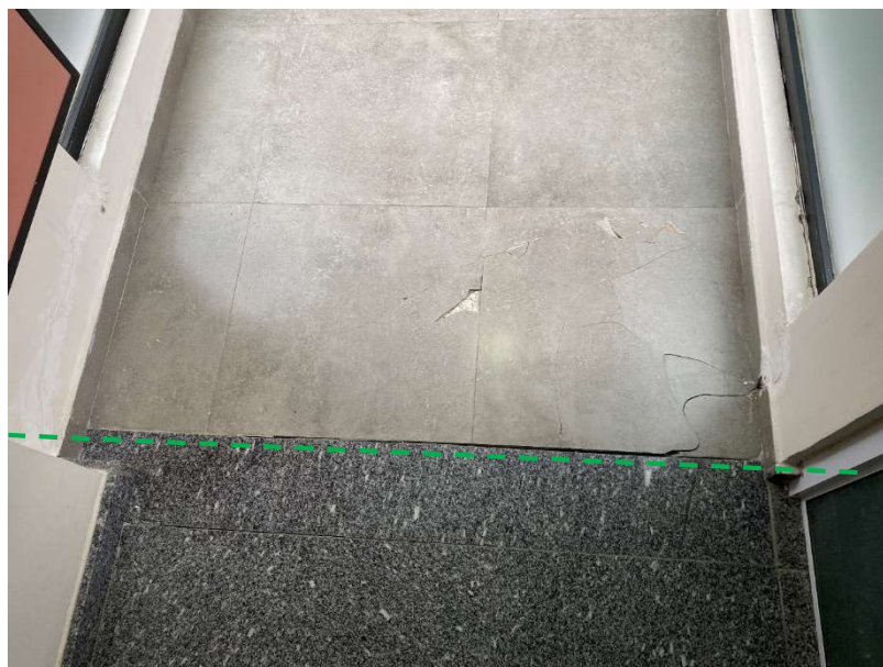
Foto 42 – Vista do local de encontro entre as estruturas que não apresenta junta de movimentação.
