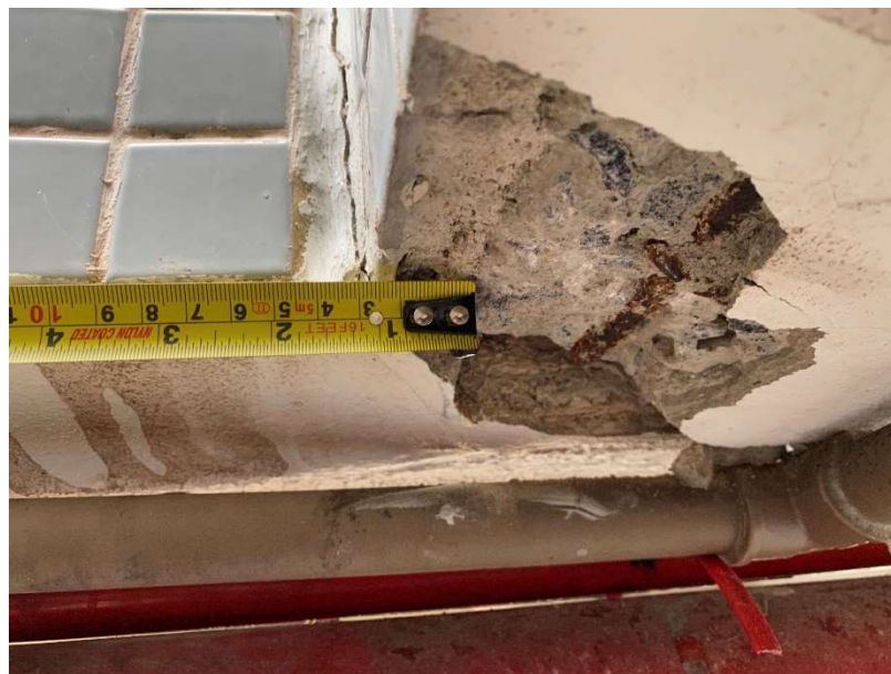
Foto 36 – Foi realizada a remoção parcial do emassamento e constatou-se que este apresenta espessura de 1,90 cm na face externa da viga.
