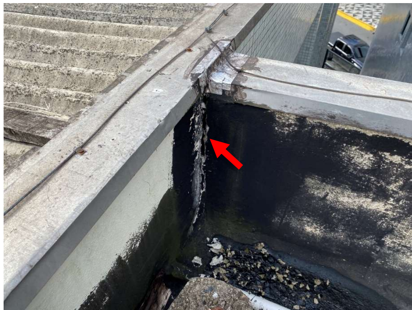
Foto 61 – Foi constatada a ausência de junta de movimentação no emassamento da alvenaria sobre a laje de cobertura da passarela do segundo pavimento.
