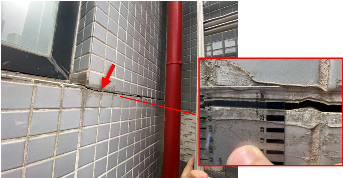
Foto 16 – Foi constatada rachadura de 3,00 mm na alvenaria da passarela, na altura do segundo pavimento.
