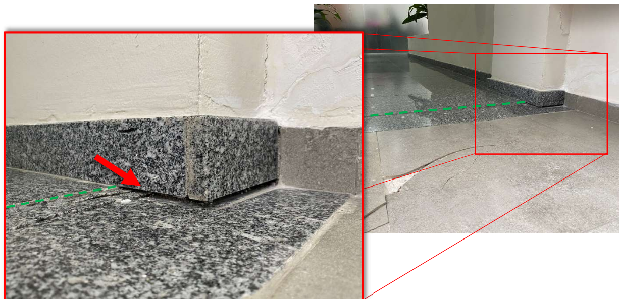
Foto 44 – Foi constatado o recalque do piso da passarela de acesso ao Bloco II.
