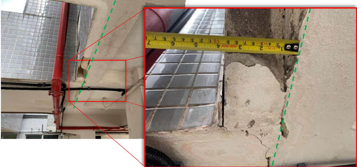
Foto 18 – Vista inferior da passarela do segundo pavimento. Foi constatado que a fachada do bloco principal, apresenta camadas de emassamento de 9,30cm, avançando sobre o encontro entre as estruturas.
