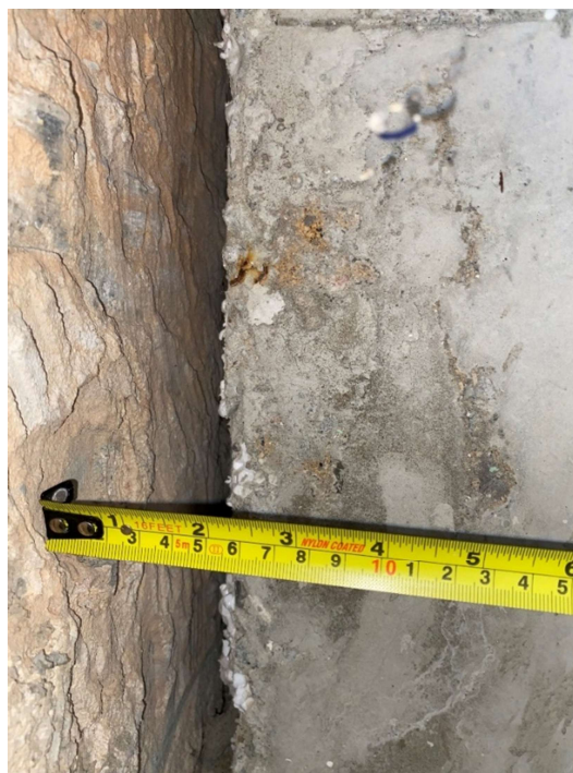
Foto 26 – Foi constatado o afastamento de 5,00 cm entre a viga da passarela e a viga do bloco principal sem material de preenchimento.
